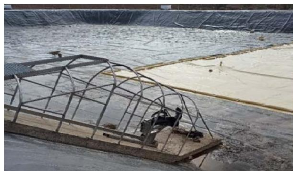
Figura 2. Sistema de protección del agitador, antes de la instalación de la cubierta flotante. Fuente: DACC.
