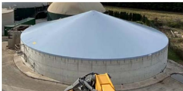
Figura 6. Depósito de purines con cobertura conoide. Fuente: UPBIOGAS.
