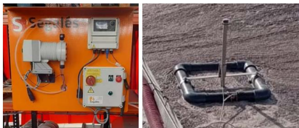
Figura 6. Panel equipo dosificación y sistema flotante de medida de pH en la balsa. Fuente: Mecánicas Segalés SL.
