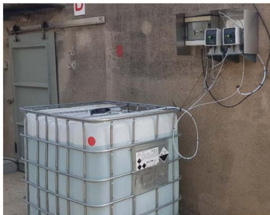
Figura 2. Sistema de dosificación en el exterior de una nave con acidificación directa en fosas. Fuente: EMA Depuración SLU.
